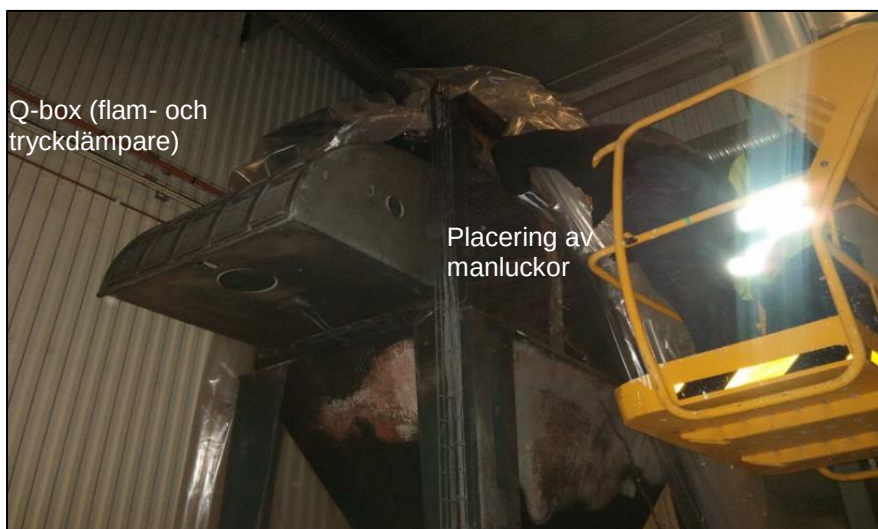
Figur 18. Filter med Q-box och bortsprängda manluckor
